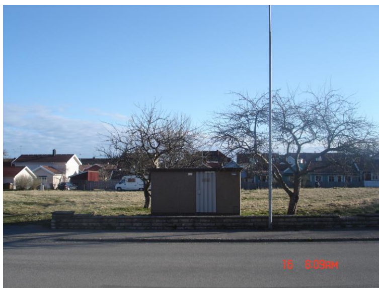
Bild 15, visar befintlig transformatorstation
